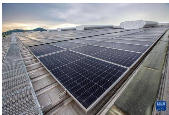
这是 11 月 7 日在泰国春武里府拍摄的工厂屋顶光伏发电项目的光伏发电板。
